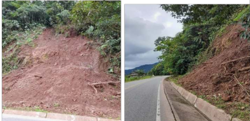
Derrumbes: Locación - tramo Jorge Chávez – El Afluyente: 199593E; 9372300N (UTM, WGS 84) Fuente; trabajo de campo
